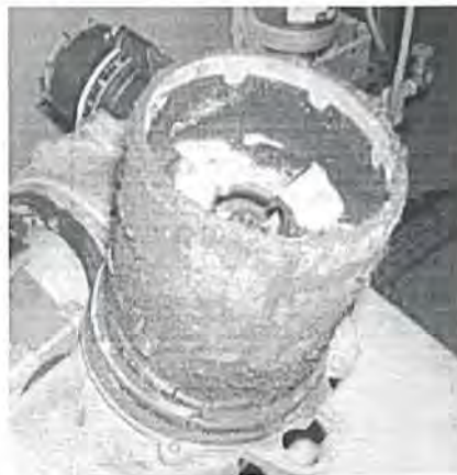
Пример грязной горелки
