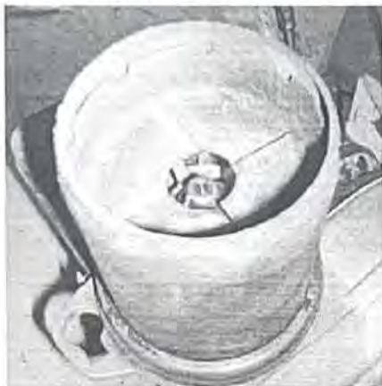
Пример чистой горелки
